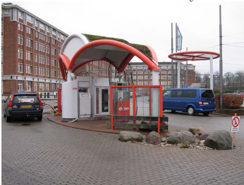
E.ON:s tankstation för biogas och vätgas i Malmö.
